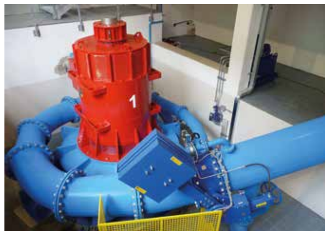
Pelton turbine 5-düsig, 450 kW, Val di Sole (Italien-Trient) Turbina Pelton a 5 getti, 450 kW, Val di Sole (TN)
